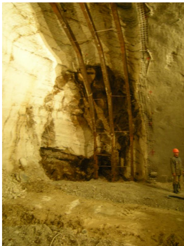
Рис. 1. Зона разупрочнения (карстовая полость, заполненная глиной), выявленная при проходке автодорожного тоннеля №1 со стороны южного портала
